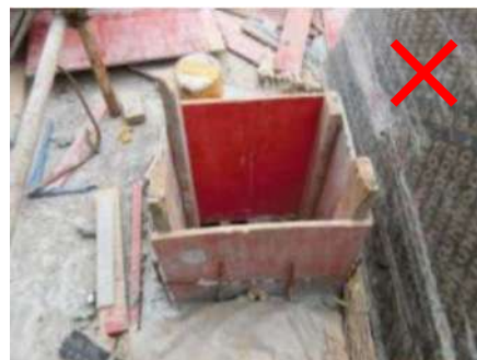
图6.47 烟道翻边未一次性浇筑
