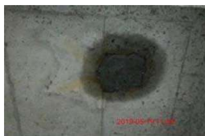
图6.40 吊洞不密实、渗漏
