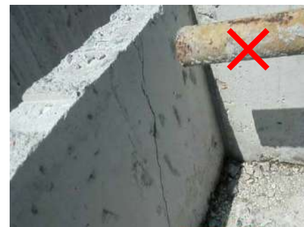
图6.48 屋面翻边断裂
