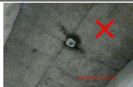
图6.33 线盒周边渗漏
