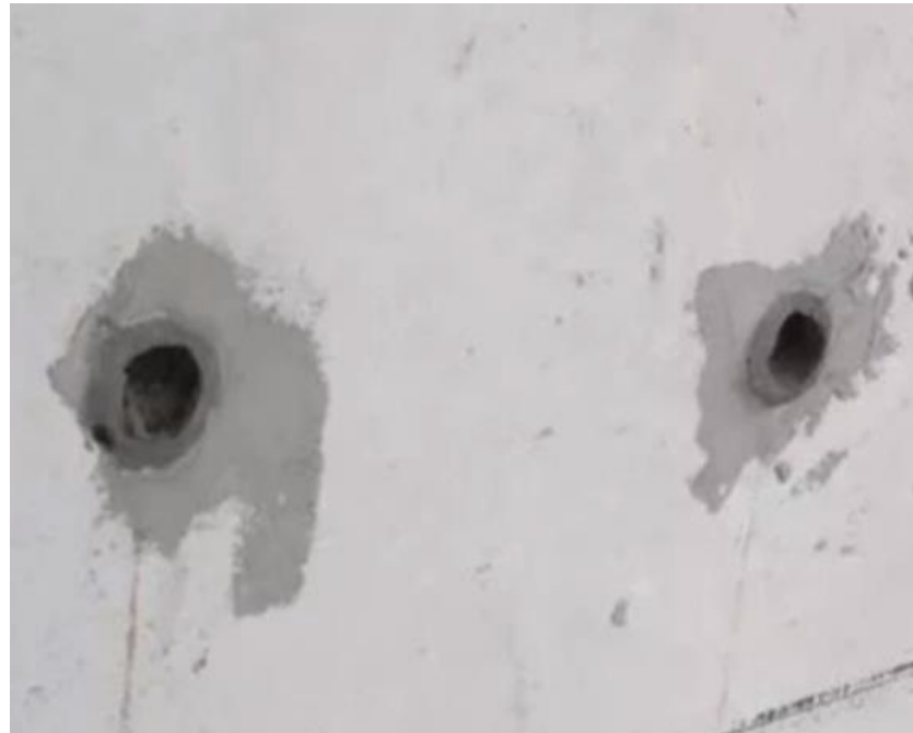
出浆孔内浆料不满
