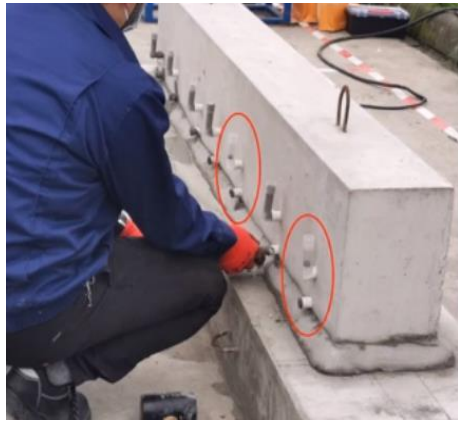
出浆孔未出浆
