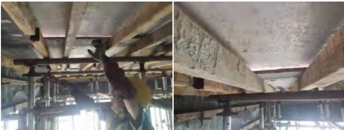
叠合板板底与模板存在较大缝隙
