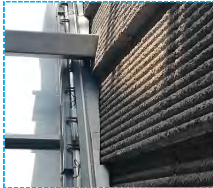
玻璃幕墙金属框梁与GRC板交接处呈锯齿状
