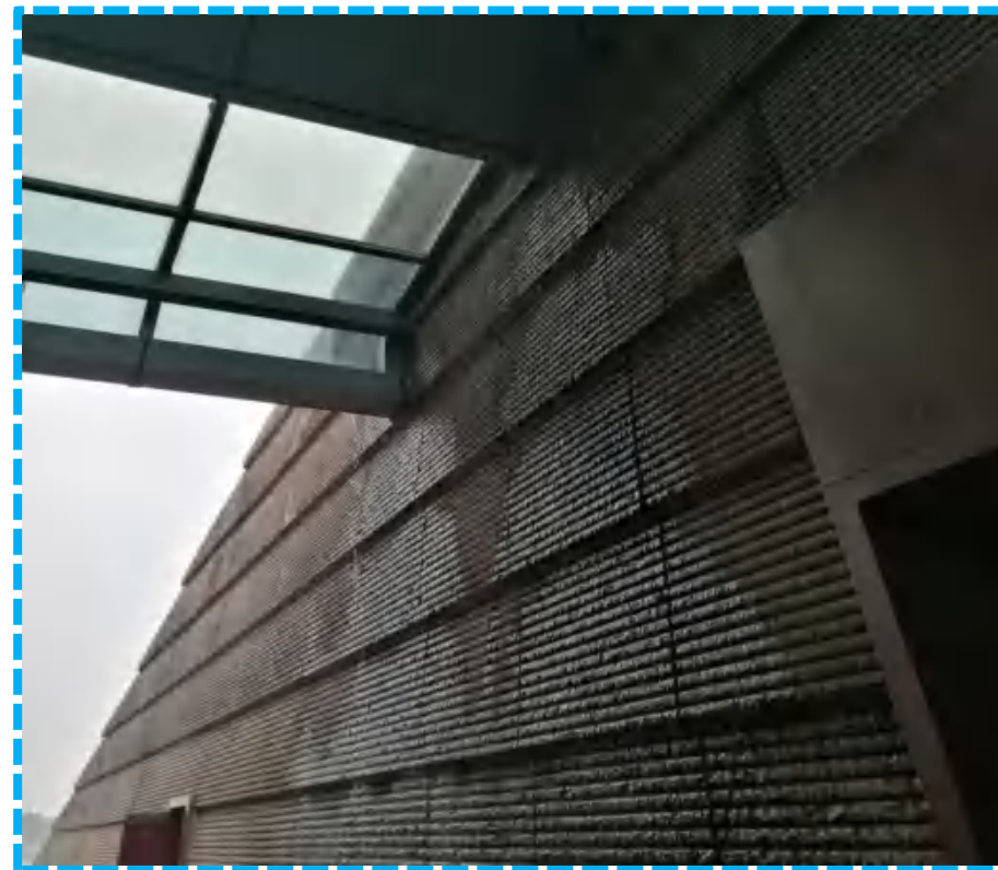
玻璃幕墙与GRC外墙板交接处渗水
