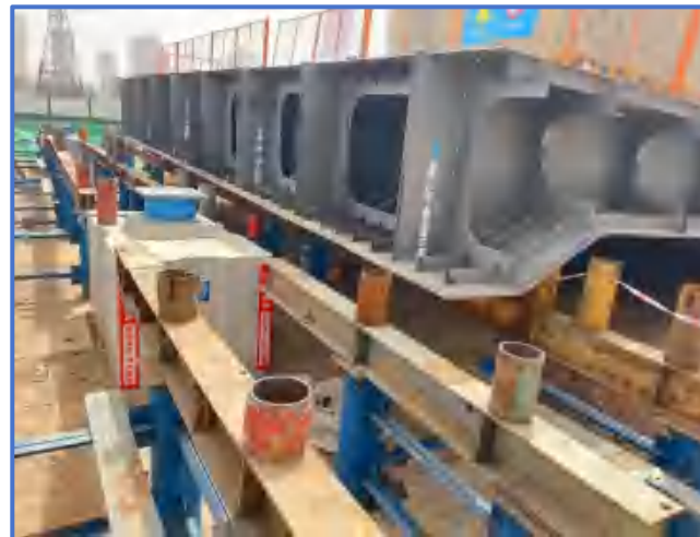
图9-43 钢箱梁地基基础
