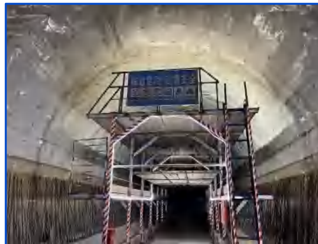
图9-90 隧道作业台架
