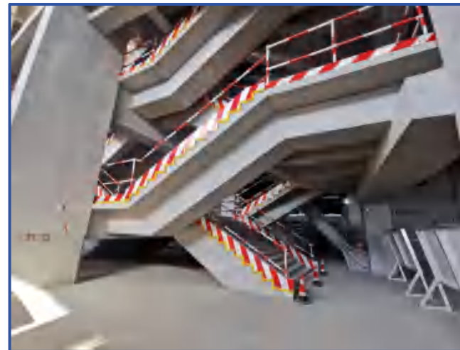
图6-22 楼梯临边防护
