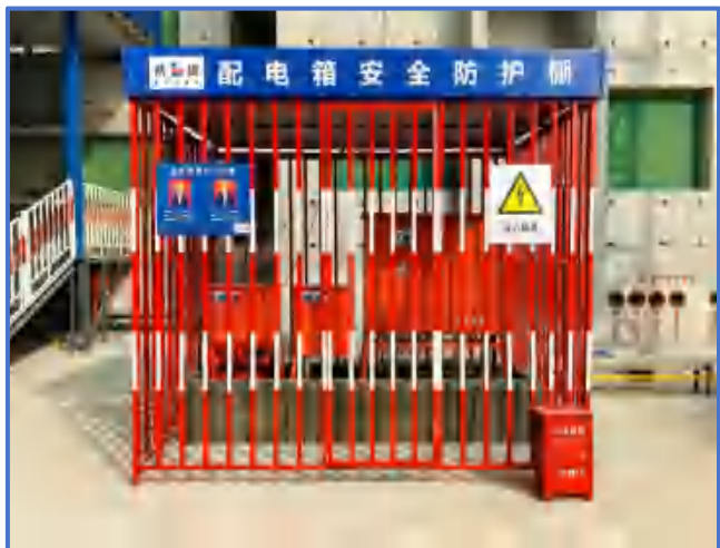
图4-27 配电箱防护棚（3）
