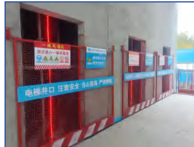
图6-15 电梯井口防护门
