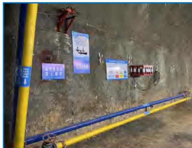
图9-85 隧道高压风、水管布设
