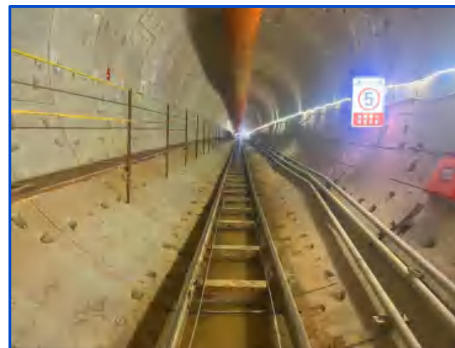
图9-113 隧道内轨行区安全防护
