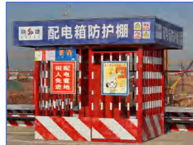
图4-27 配电箱防护棚（4）
