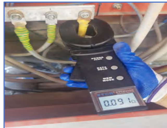
图4-31 电阻测试仪测试接地电阻
