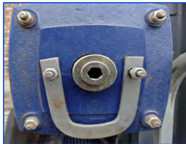
图5-67 手动松闸装置
