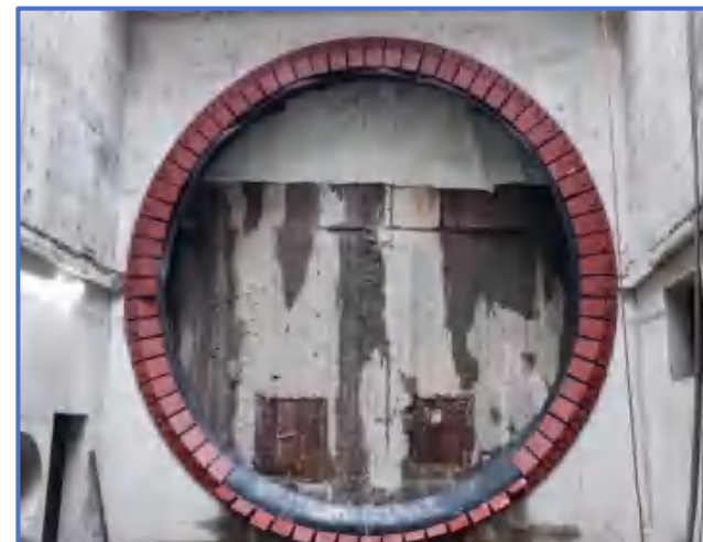
图9-28 洞口止水装置
