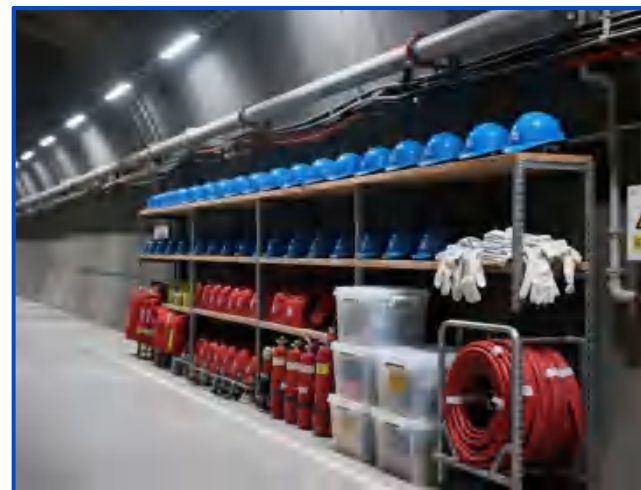
图9-87 隧道内应急设施
