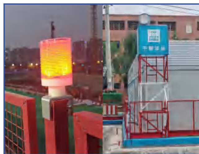
图1-22 安全警示灯、夜间照明
