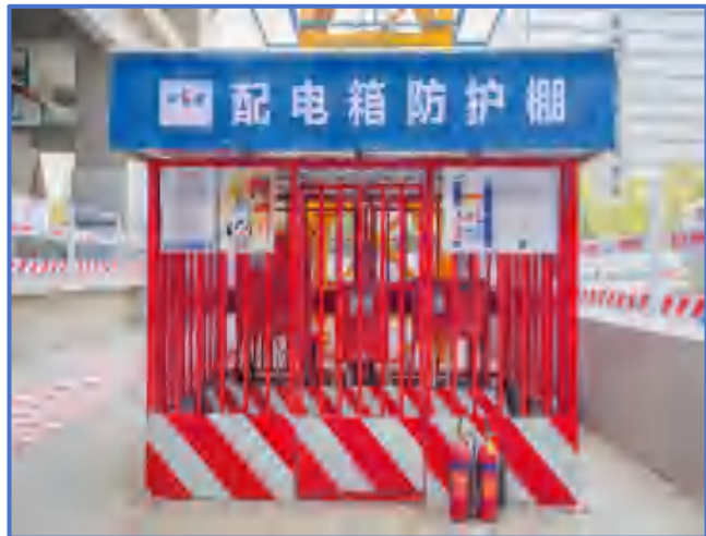
图4-27 配电箱防护棚（1）
