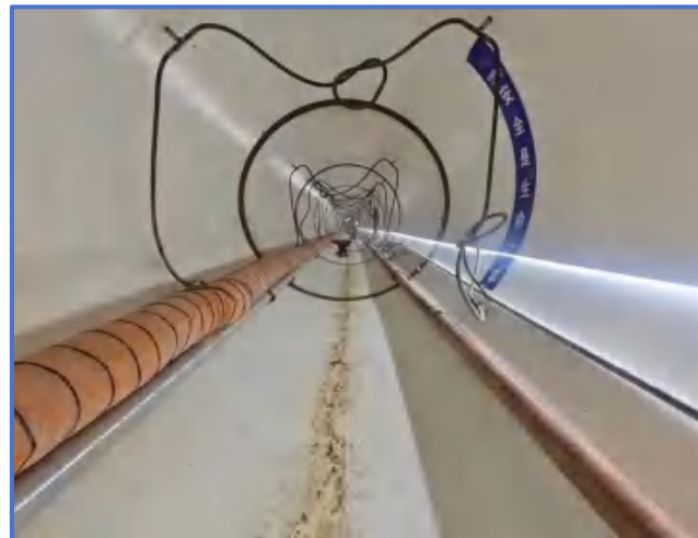
图9-35 管道通风设施
