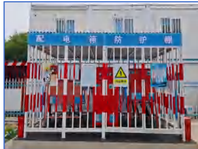
图4-27 配电箱防护棚（2）
