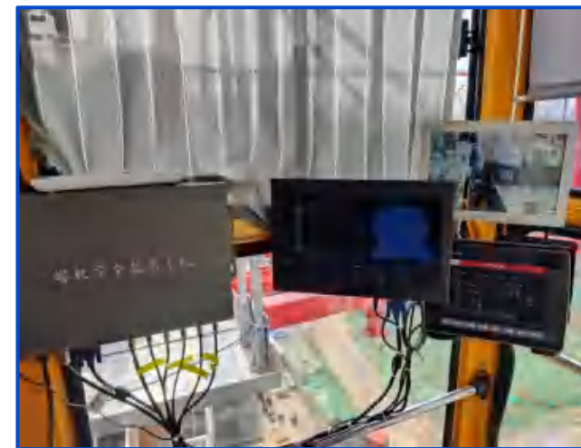
图5-41 塔机安全监测系统
