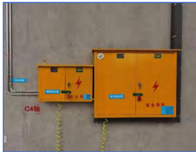
图4-13 楼层墙面设置固定配电箱
