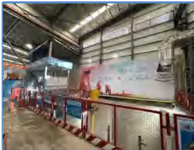
图9-67 竖井口临边防护
