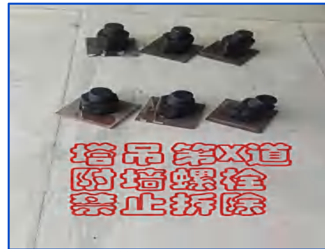
图5-5 附墙螺栓警示可视化
