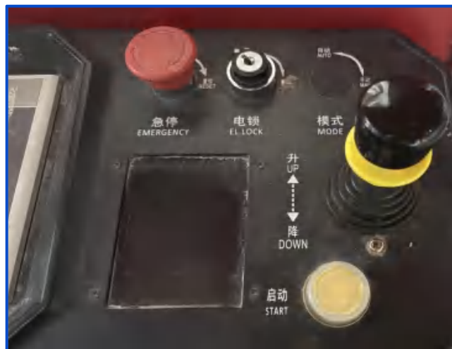
图5-60 急停开关（笼内）
