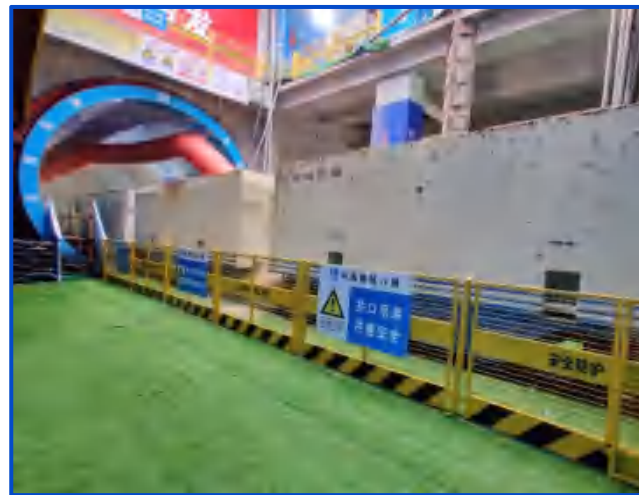
图9-112 站内轨行区安全防护
