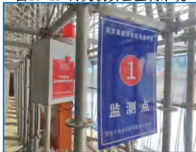
图10-46 高支模安全监测装置
