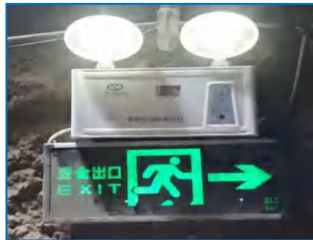
图9-83 隧道LED应急照明灯
