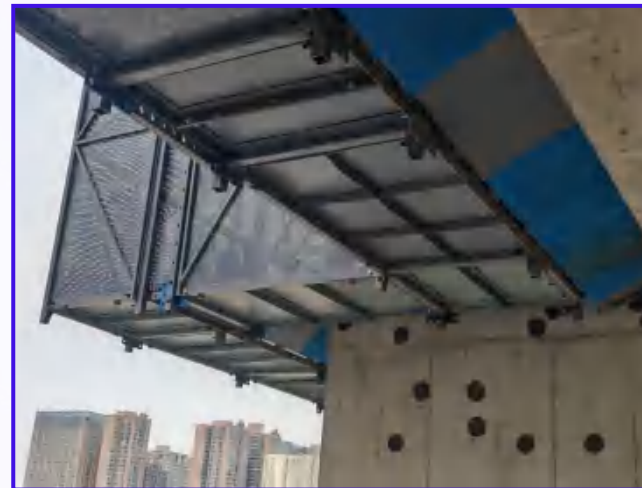
图2-32 架体与结构缝隙处翻板
