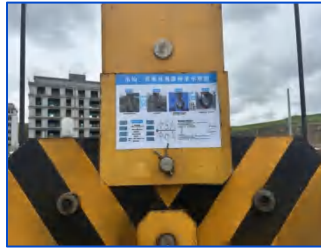
图5-45 吊钩检查可视化标识牌
