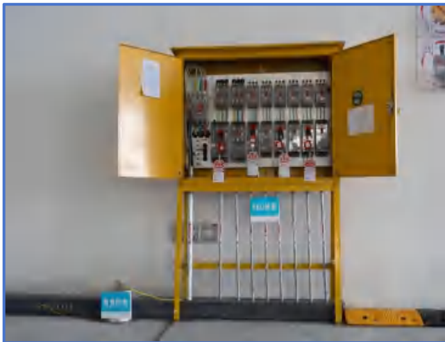
图4-23 配电箱进出线
