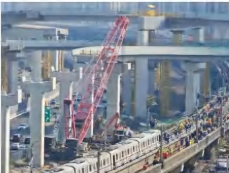
▲线路设施和列车受损。
