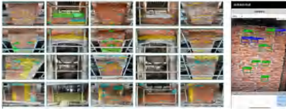
图 3-4 清水砖墙劣化识别训练样本&劣化识别应用示意图
