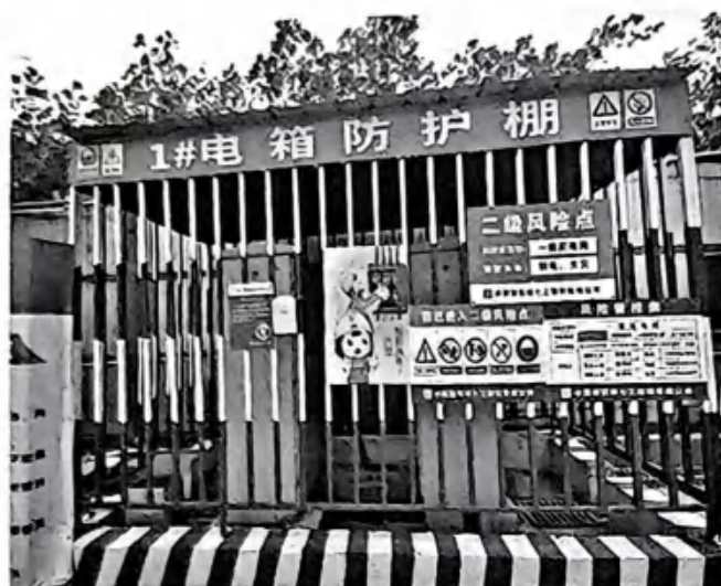
图 3-17 配电箱防护棚
