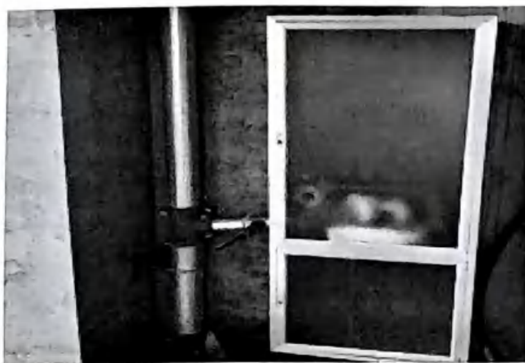
图 3-15 楼层消防（永临结合）
