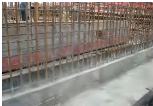
外墙水平施工缝
