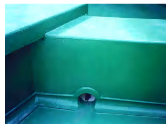
反梁过水孔实物图（二）
