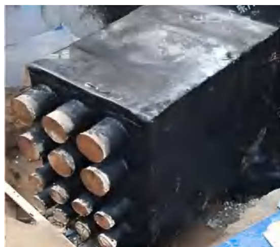
防水材料包裹的混凝土墩
