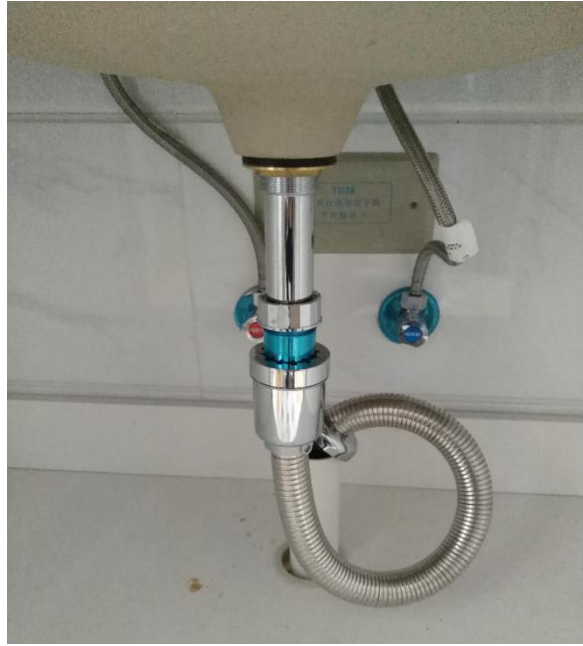
浴室柜排水现场照片
